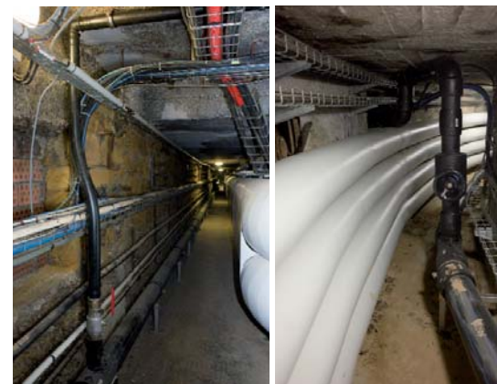
Ce site a été construit entre 1903 et 1909. Ses concepteurs allemands ont conçu cette galerie technique où ont été disposés tous les principaux réseaux de fluides : eau sanitaire, chauffage, électricité, réseaux de communication, points de comptage d'énergie...
