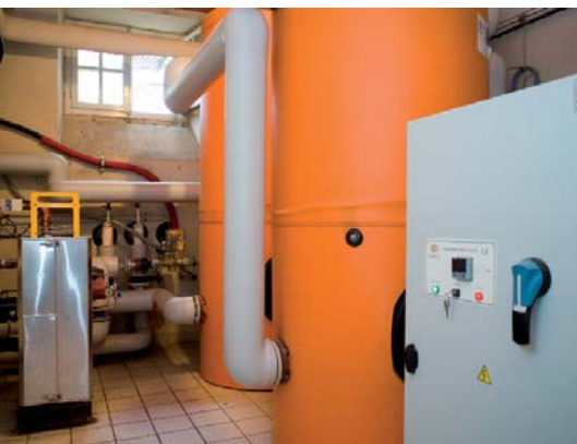
Un local de production d'eau chaude sanitaire. L'échangeur à plaques reçoit prioritairement l'énergie du réseau de chauffage du site. L'appoint est assuré par une chaudière électrique.
