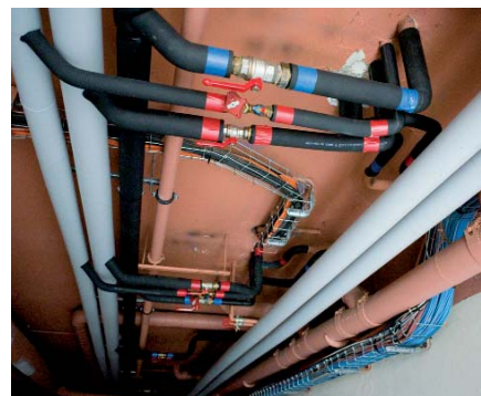
Les colonnes techniques de distribution d'ECS. Eau froide et chaude bouclée sont directement piquées sur le circuit au plafond des sous-sols.
