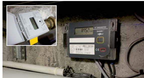
L'ensemble du site a été instrumenté pour relever les consommations d'énergie et d'eau.
