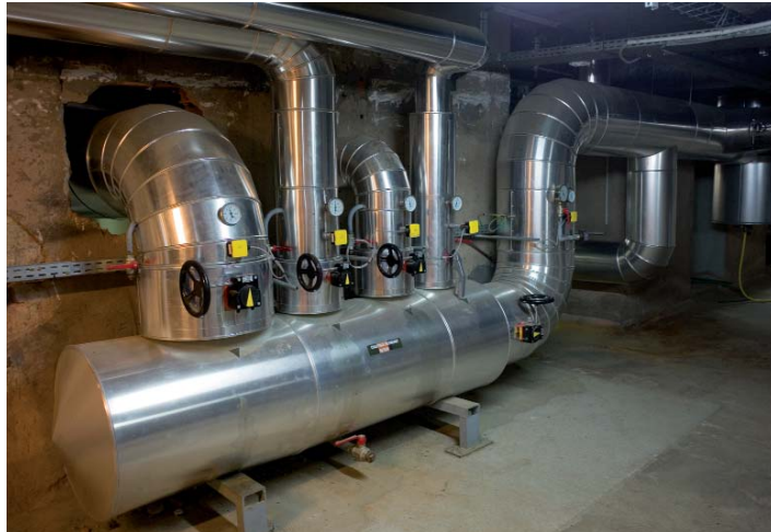
Le retour des réseaux desservis par le réseau de chaleur. Au cours des dernières années, chaufferie, réseaux primaires, régulation... ont été renouvelés.
